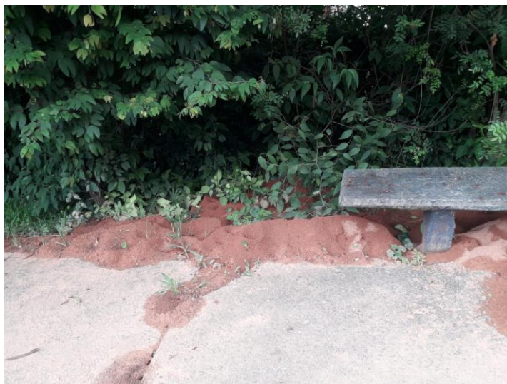
Figura 12: Formigueiro em área externa da calçada
